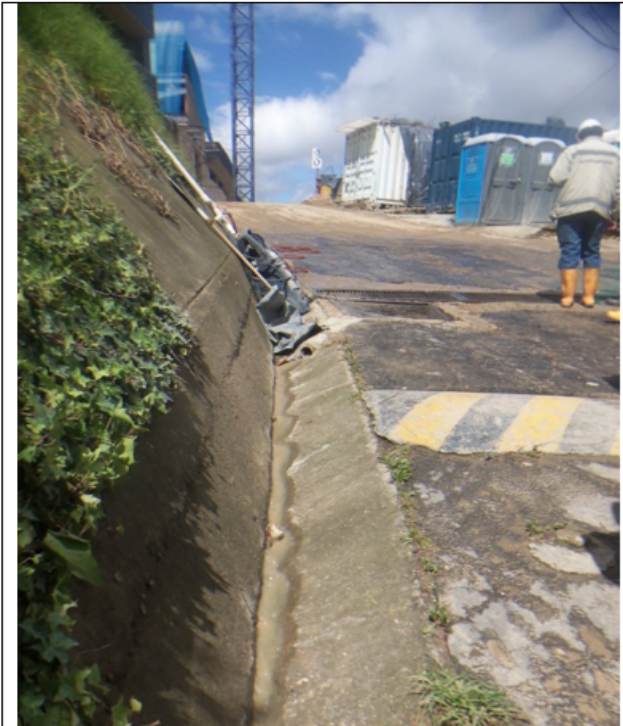
Foto 1. Se evidencia el vertimiento directo de agua residual con sedimentos disueltos a componente del espacio público (cuneta) que conduce las mismas a la Quebrada Padre de Jesús.
