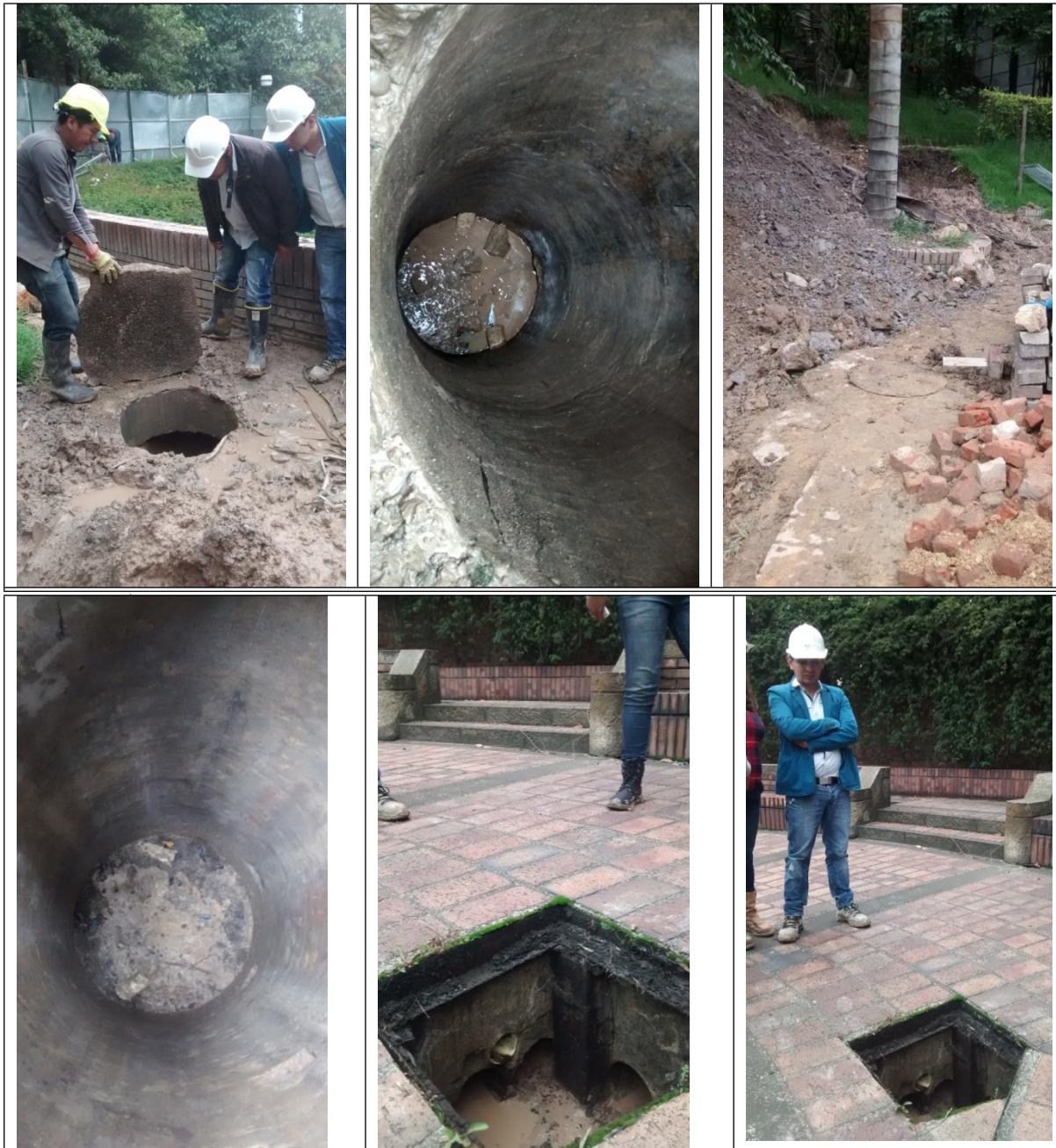
Fotos 25, 26, 27, 28, 29, 30,31, 32 y 33. No se implementan medidas de manejo ambiental para prevenir la afectación de los componentes del sistema de drenaje urbano. Se observa como el lodo y los escombros entran a los componentes del sistema de drenaje urbano.
