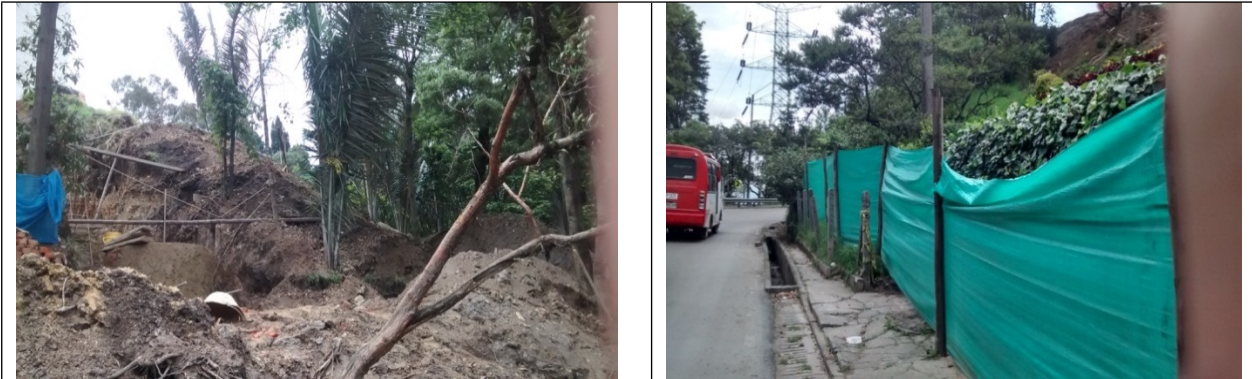
Fotos 15, 16, 17, 18 y 19. No implementan medidas de manejo ambiental para evitar la salida de agua disuelta con sedimentos al espacio público por la escalera, debajo del cerramiento. No están cubiertos los acopios de material de excavación que por acción de la temporada de lluvia arrastra los sedimentos hacia el espacio público que conduce a su vez los mismos hacia el sistema de drenaje urbano.
