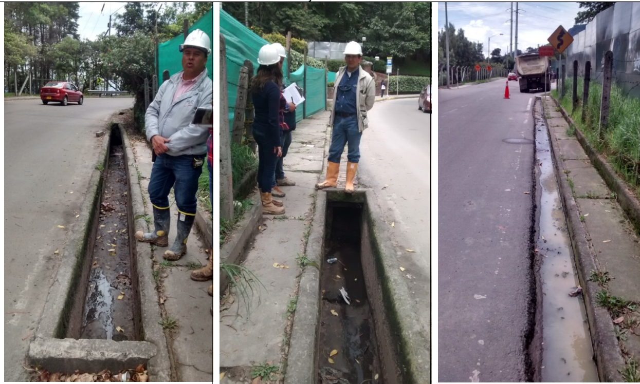
Fotos 20, 21 y 22. No implementan medidas de manejo ambiental para evitar la salida de agua disuelta con sedimentos al espacio público por la escalera, debajo del cerramiento. No están cubiertos los acopios de material de excavación que por acción de la temporada de lluvia arrastra los sedimentos hacia el espacio público que conduce a su vez los mismos hacia el sistema de drenaje urbano.
