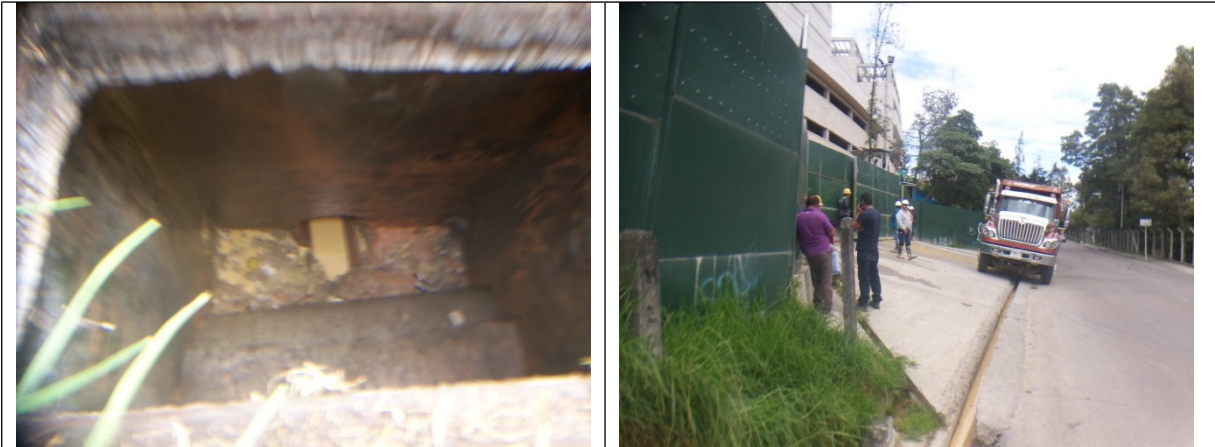
Fotos 11, 12, 13 y 14. En el momento de la visita personal de la obra estaba evacuando esta agua lodosa al espacio público que conduce las mismas a componente del sistema de drenaje urbano.
